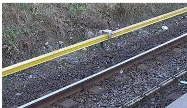
Alimentación por tercer carril del Metro de Ámsterdam
