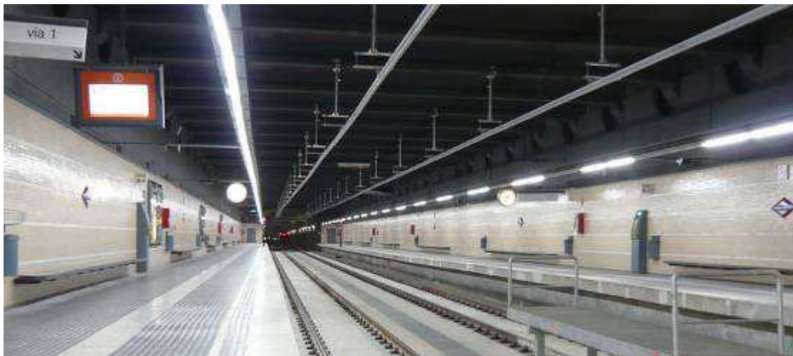
Catenaria aérea de la estación de Terrassa-Rambla (FGC)
