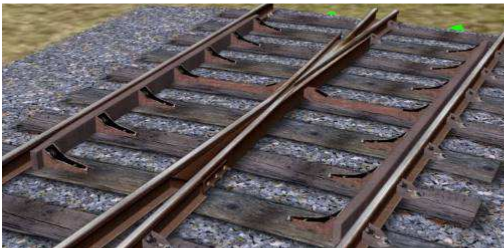
Contracarriles en un cruzamiento
