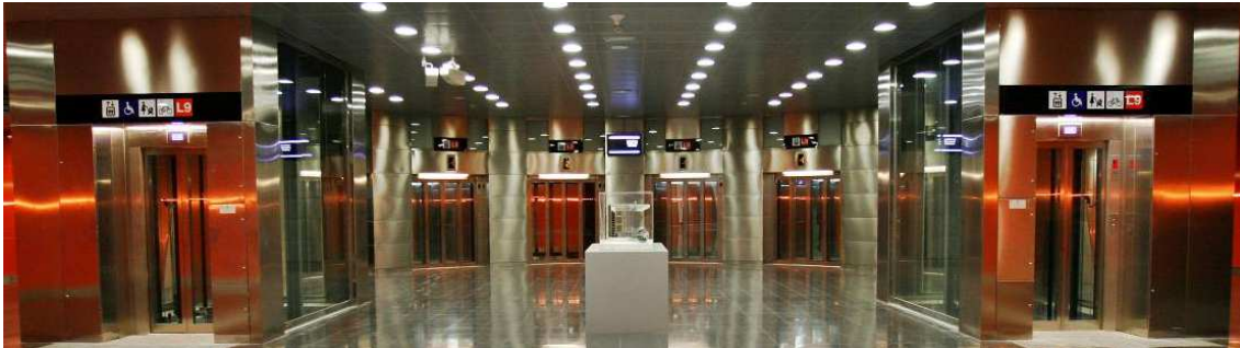
Imagen ascensores estación
