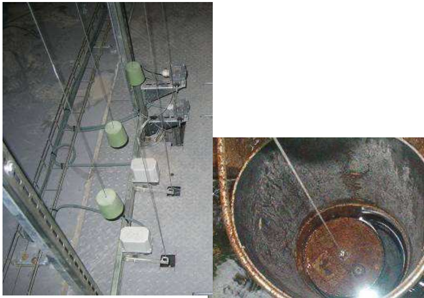
Imagen sistema de flotadores
