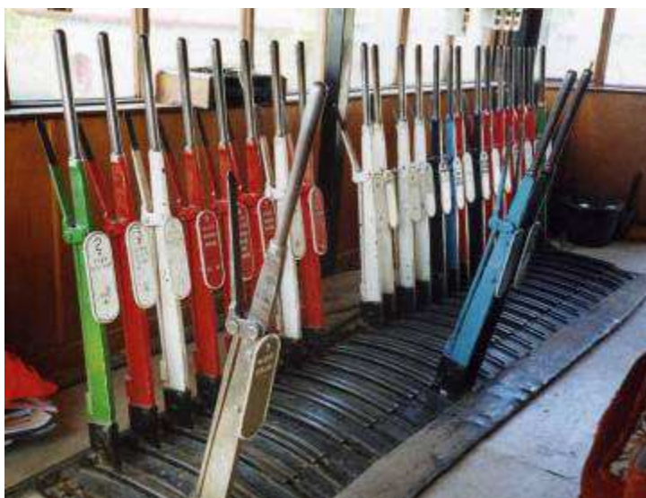
Cabinas de concentración de palancas
