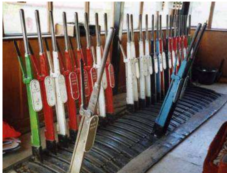
Cabinas de concentración de palancas
