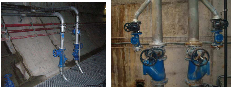
Imagen sistema de válvulas y tuberías
