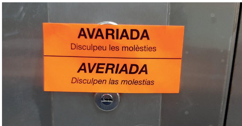
Adhesivo en la puerta del ascensor donde puede leerse «AVERIADA»
