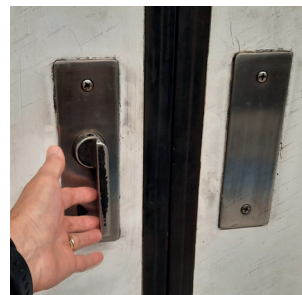
Palanca para abrir la puerta
