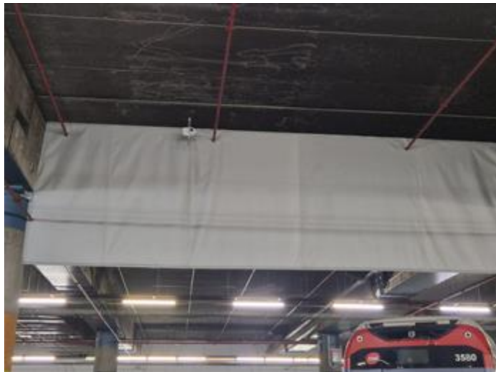
Cortina sectorització i CCTV
